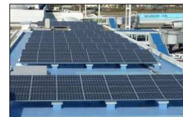
太陽光発電（国内線ターミナル屋上）
