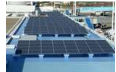
太陽光発電（国内線ターミナル屋上）
