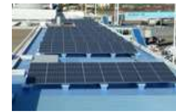
太陽光発電（国内線ターミナル屋上）
